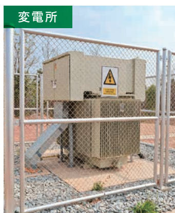
変電所 普段は人気のない施設の管理に。
